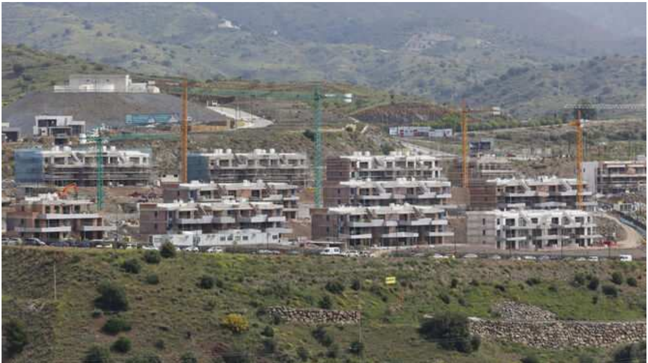
Obras de varias promociones de viviendas en Colinas del Limonar. / JAVIER ALBIÑANA
